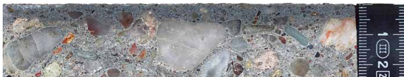
Zmieniona struktura utwardzonego materiału bezpośrednio pod betonową powierzchnią jest wyraźnie widoczna.
